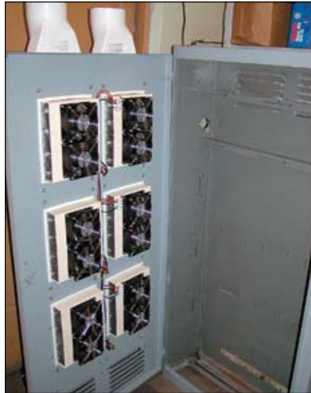
Рис. 14. Шкаф с установленными термоэлектрическими сборками
